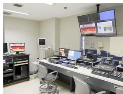
調整室内 操作機器
