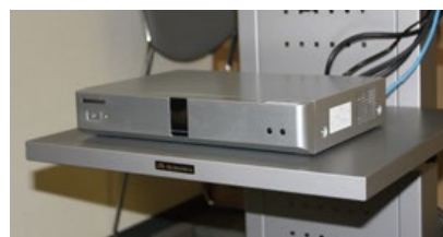
専用ラックに設置されている機器 (KX-VC600)
