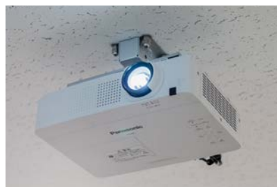
天井に設置されたプロジェクター
