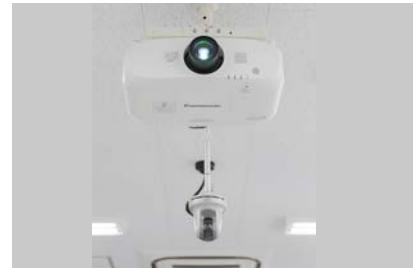
天井面に設置されたHDカメラとプロジェクター
