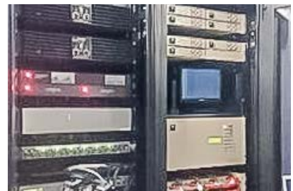
M.バックヤードのAV機器ラック
