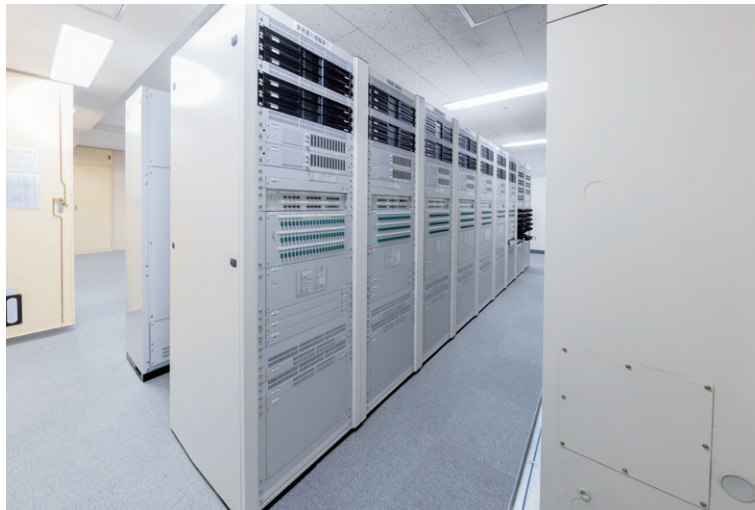
▲パワーアンプは1UサイズのコンパクトなRAMSAデジタルパワーアンプWP-DM912を採用。放送機器室のラック数を改修前の47架から20架まで削減でき、大幅な省スペース化に貢献
