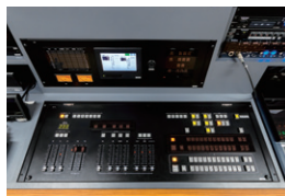
▲実況放送室に設置された制御卓(特注品)
